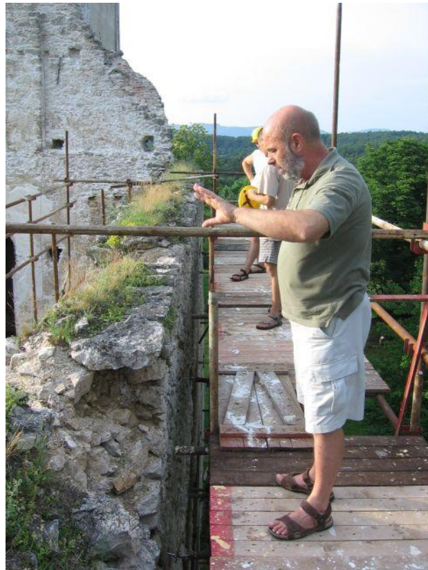
Obr. 3 Profil degradovanej koruny muriva - postupné ubúdanie vyplavenej malty smerom ku lícam múru a následná deštrukcia až do jadra, na korune vidno pôvodné zatrávnenie. Obhliadka statikom V. Kohútom, 2006.
